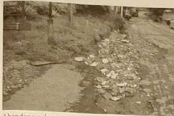
Abandono e descaso com nossos confeccionistas. Diante a falta de manutenção e perante a precariedade das ruas no setor das lavanderias, os buracos estão sendo tampados com restos de construções para dar acesso às empresas.
