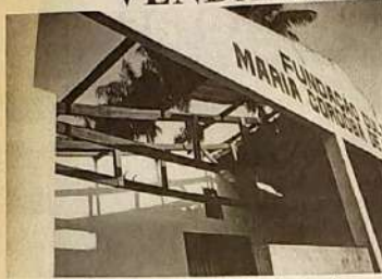
Telhado danificado no pavilhão das salas de aula.
