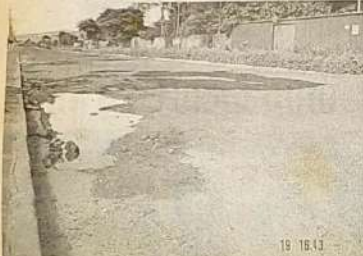
Avenidas de Jaraguá danificadas
