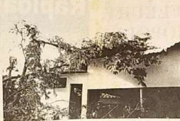
Árvores caídas sobre um dos pavilhões.
