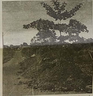
Sem a menor sinalização, a execução dos serviços pela gerência da Saneago de Jaraguá está próxima a ocasionar graves acidentes de trânsito
