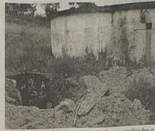
Serviços de manutenção em válvulas foram realizados e ficaram sem a devida conclusão, expostos ao tempo
