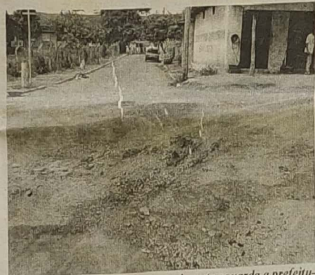
Danificado pela Saneago, o pavimento aguarda a prefeitura descobrir a existência do buraco para poder corrigir
