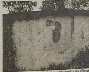
Caixas de contenção de água instaladas no alto do morro, apresentam rachaduras e remendos feitos sem o menor cuidado
