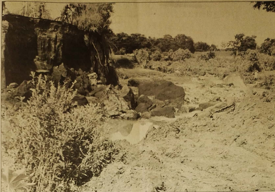
O asfalto da BR 153 não resistiu às fortes chuvas
