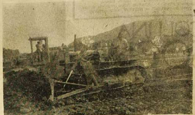
O flagrante colhido pelo nosso fotógrafo, mostra-nos o instante que as máquinas já estavam quase concluindo os serviços de terraplenagem para nova sede do BAR, DORMITÓRIO, POSTO e CHURRASCARIA SERRA DOURADA.
