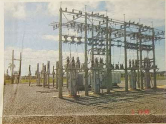
A SE conta com abertura em três alimentadores de 13,8 KV
